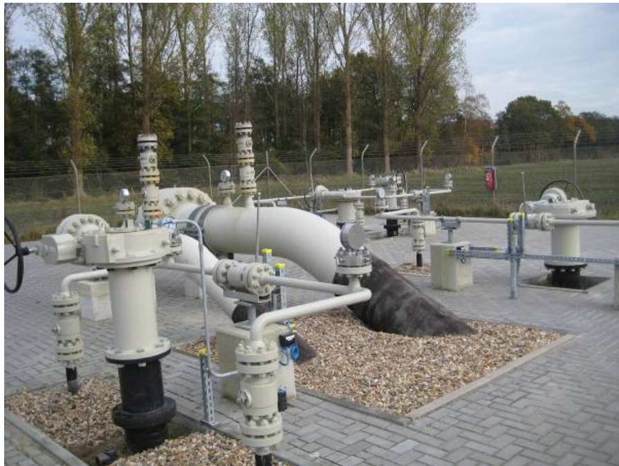
Nordstation mit Streckenschiebern und Molchstation
